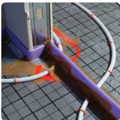
Rørgjennomføring mellom to rom.
