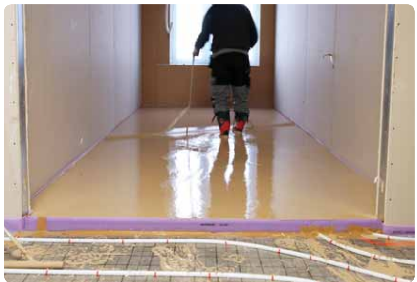
A-plan flyter lett ut og rommene støpes enkeltvis pga den raske herdetiden. I forkant kan vi se avgrensingen med kantsoleringen som støttes opp av en transparent plastvinkel.
